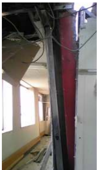
建物本体が大きな被害を受けた長町附属クリニック
