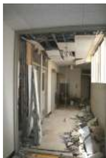
崩壊したクリニック内部
